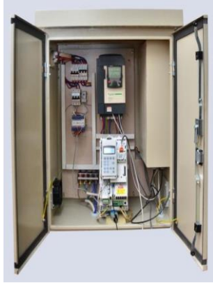
Şəkil 8 MDSİS qurğusunun görünüşü
